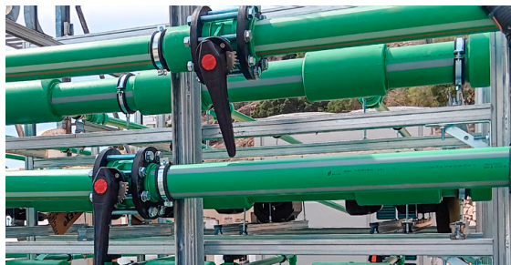
Instalación ACS, España. / ACS installation, Spain.
